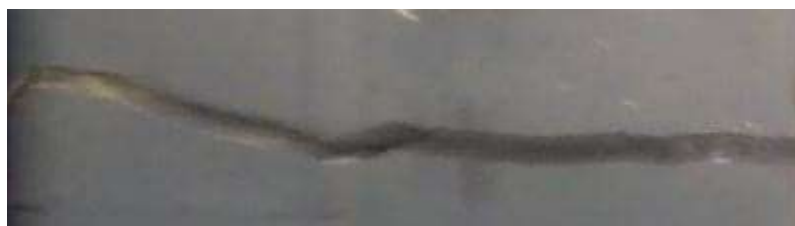
Рисунок 1 – Фрагмент кадра с трещиной
